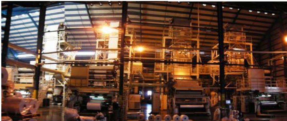
Figura 3 Vista del conjunto de extrusoras de la Planta I
